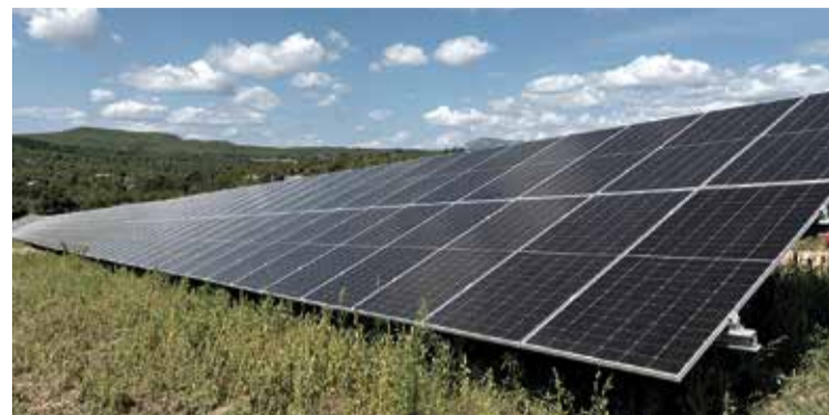
INSTAL·LACIÓ SOLAR. També troben que és un bon lloc l'antic peatge de la Jonquera
